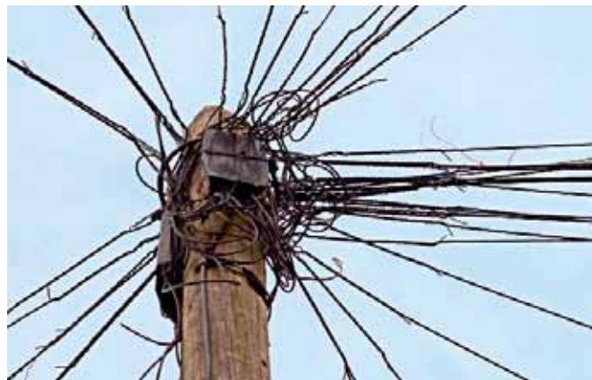
Kable telefoniczne, na szczęście jeszcze nie w Wesołej (fot.: Andrew Martin, Pixabay)
